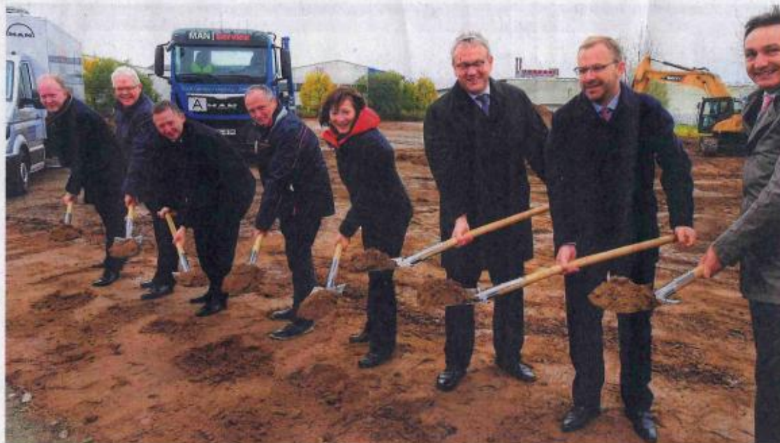
Viel Prominenz ist zum ersten Spatenstich für das neue Firmengelände nach Zorbau gekommen.
