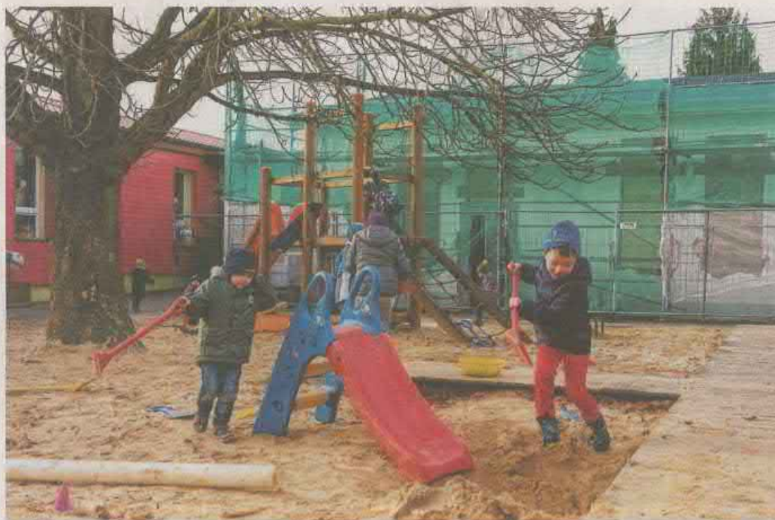
Gerüste an der Saubacher Kindertagesstätte „Rasselbande“ künden von den Bauarbeiten, derweil wird der Betrieb der Einrichtung direkt vor Ort aufrecht erhalten.
